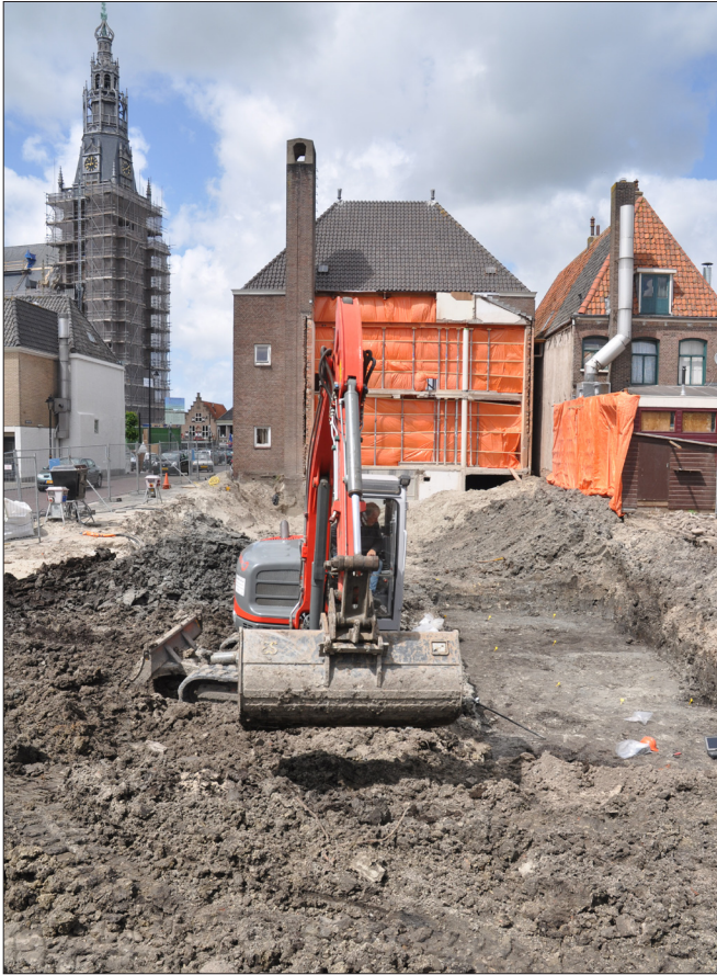
Afbeelding 13. Zicht op de onderzoekslocatie vanuit het zuiden. Rechts vlak 1 van werkput 5. Daarachter was een talud van zand en klei aangebracht om een mogelijke verzakking van het naastgelegen pand te voorkomen. Hier kon dus niet gegraven worden.
